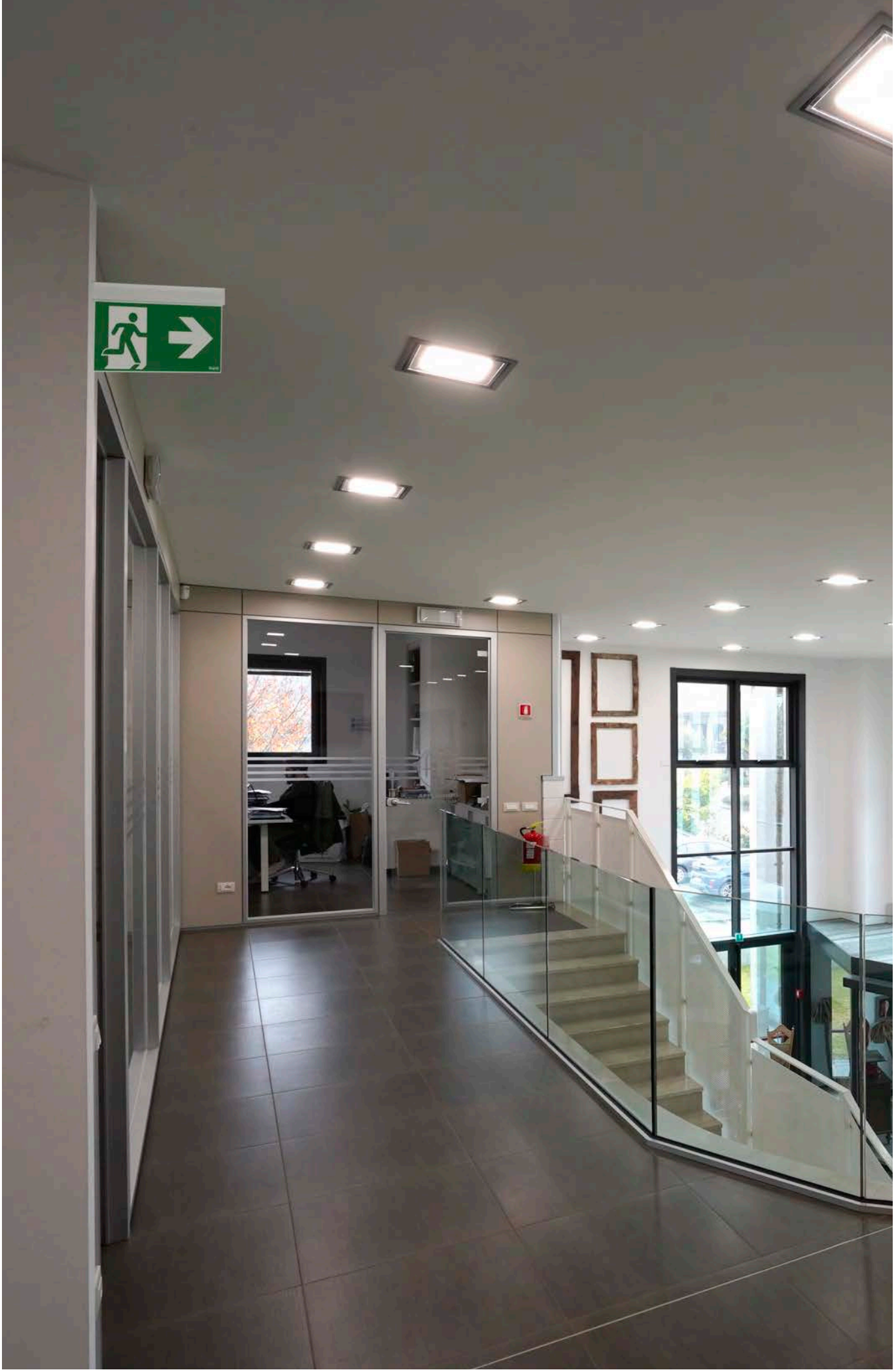
135 segnaletica / exit sign
