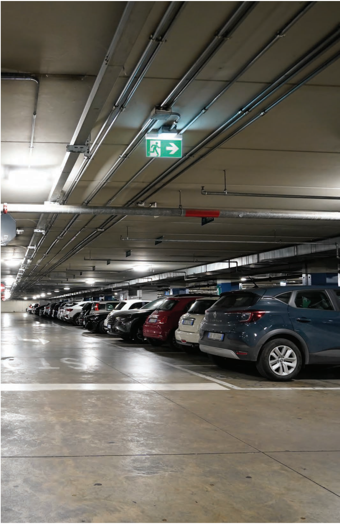
131 segnaletica / exit sign
